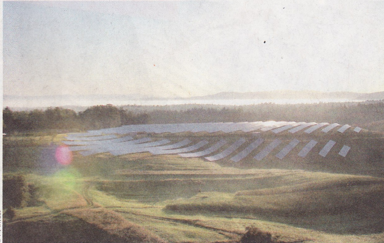
Die Anleihe für die PV-Anlage in Südslovenien läuft zehn Jahre.
